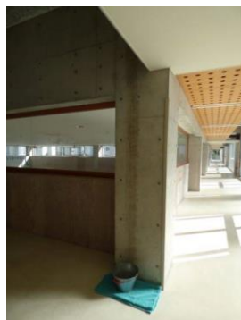
多目的ホール上柱雨漏り
