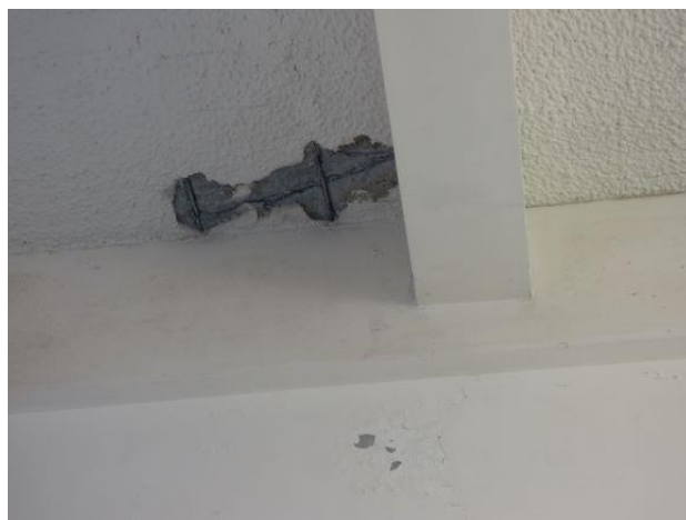
天井の崩れ(3F から屋上への階段上)
