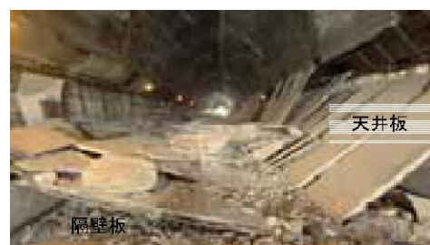
写真-4 天井板崩落状況②
