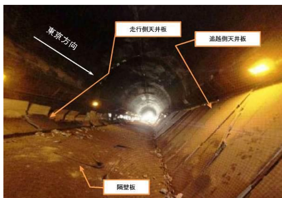
写真-3 天井板崩落状況①
