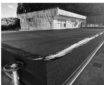
▲遮光カーテン (御宿浄水場)
